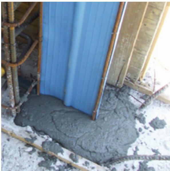
Idrostop PVC BI embebido en la losa de cimentación con Planigrout, tras demoler parte de la losa
